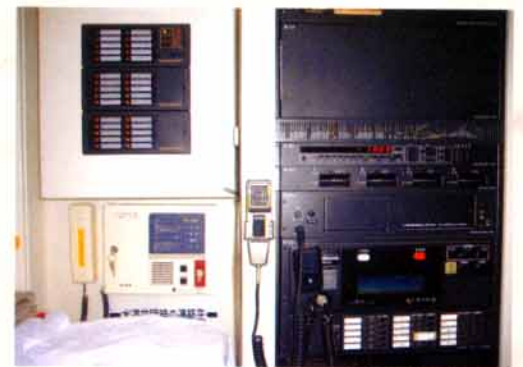
自動火災通報設備
